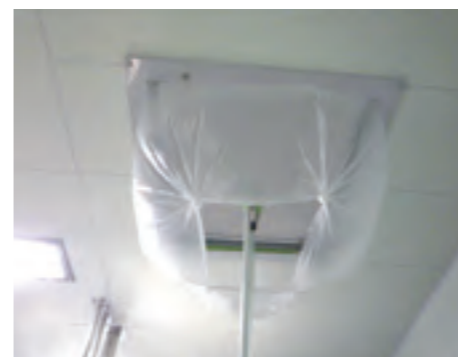
▲HEPA吹出面養生・測定プローブ
